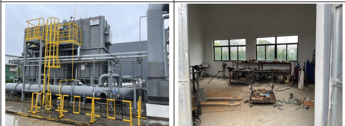
RTO 废气处理
